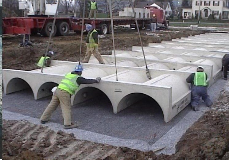
混凝土儲槽 (孔隙率70%)
