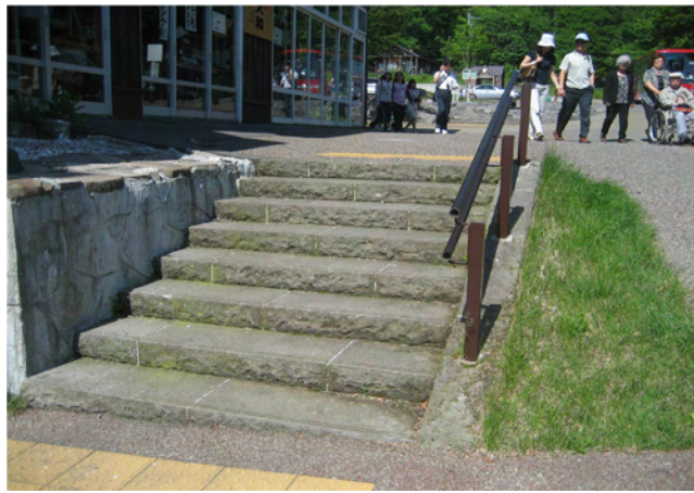
圖3-3.4 斜坡、階梯高差超過80cm應設置扶手
