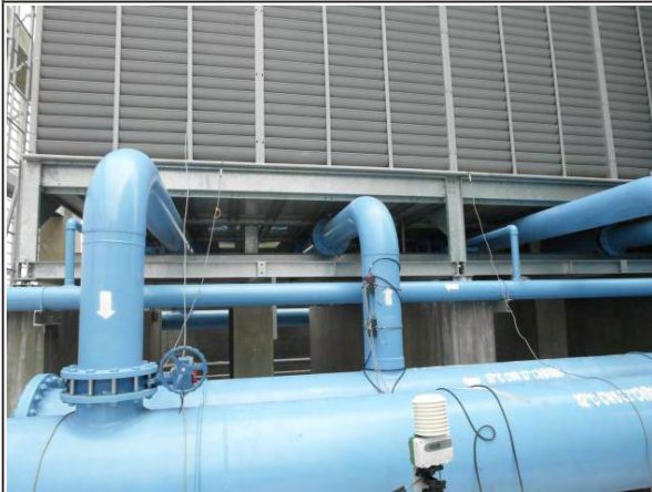
【冷卻水塔出水端溫度計安裝】
