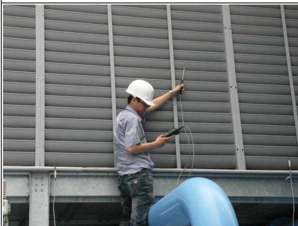
【冷卻水塔入風風速量測】
