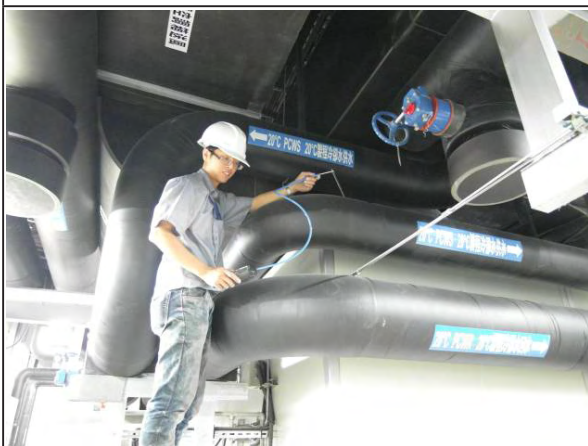
【空調箱出風風管靜壓量測】
