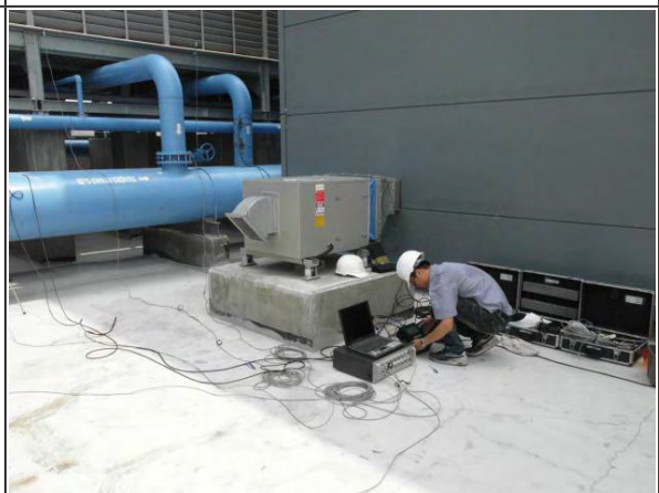
【冷卻水塔測試分析儀安裝】
