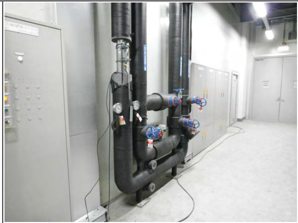
【空調箱超音波流量計安裝】
