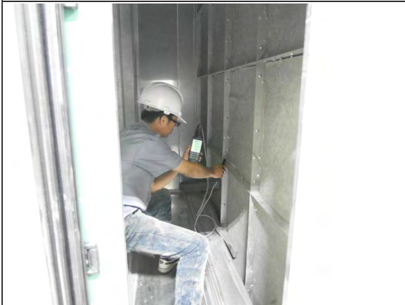
【空調箱盤管入風風速量測】
