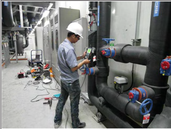
【空調箱出入端溫度計量測】
